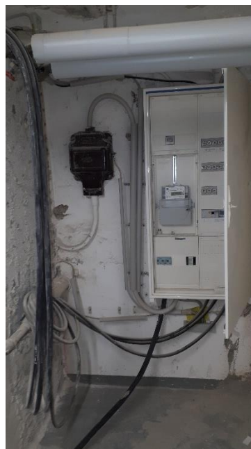
Abbildung 6: Hausanschluss in IV / V Zählernr.: 1 ESY11 6196 8253
