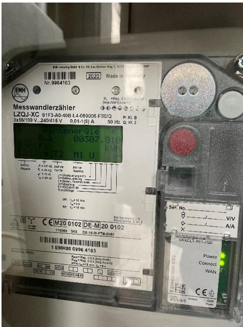
Abbildung 5: Messwandlerzähler Zählernr.: EMH00 0996 4103
